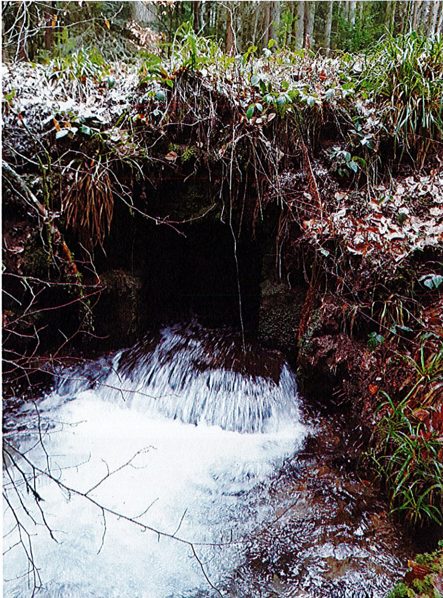
Figure 11: Vue de la chute (10cm) à l'aval du ponceau
