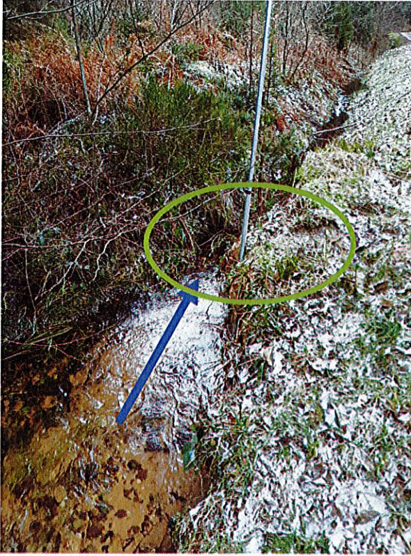
Figure 5: Vue de l'entrée de la buse de l'amont vers l'aval (sens de l'écoulement en bleu, buse en vert)
